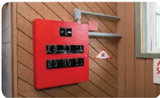
شکل ۳-۴۹- تصویر تابلو کنترل
